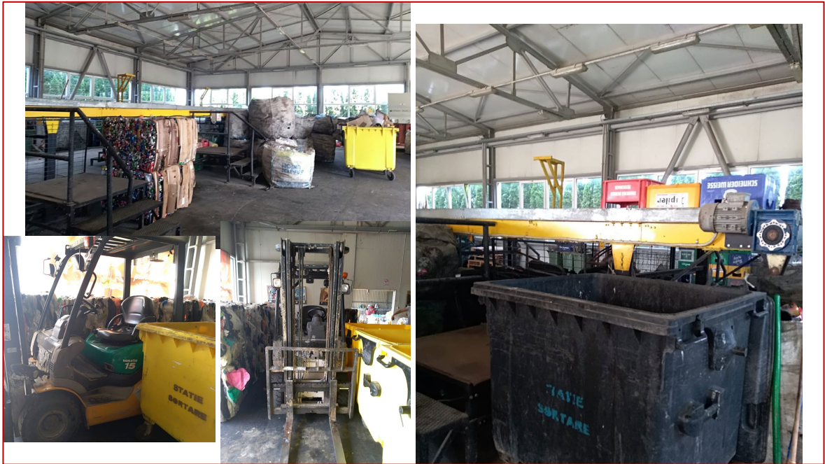
Figura 4-6: Echipamente tehnologice stație de sortare Cumpăna
